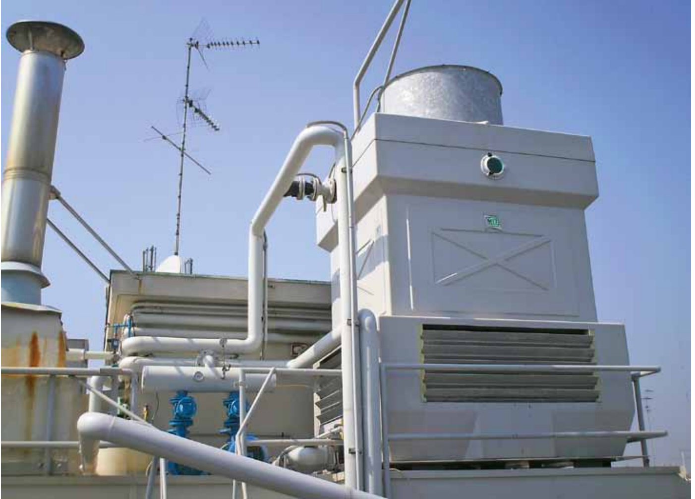
Kühlturm auf dem Dach eines Wohngebäudes.
